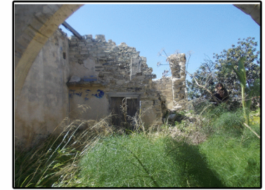
κατάρρευση μέρους λιθοδομής
