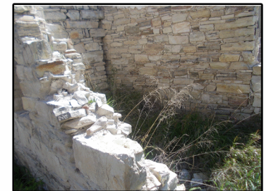
κατάρρευση μέρους λιθοδομής
